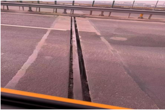
图 18 30#墩伸缩缝损坏
