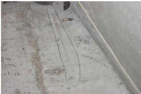
图 11-41-2#横隔板, 小桩号侧, 1 处露筋
