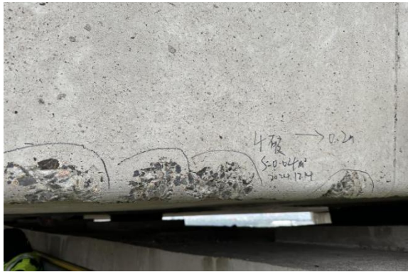
图 10-32-4#箱梁, 左腹板, 4 处破损
