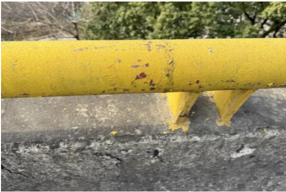
图 20 钢护栏锈蚀涂装老化开裂
