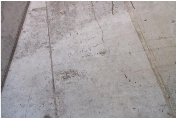
图 28 43-2#横隔板斜向裂缝
