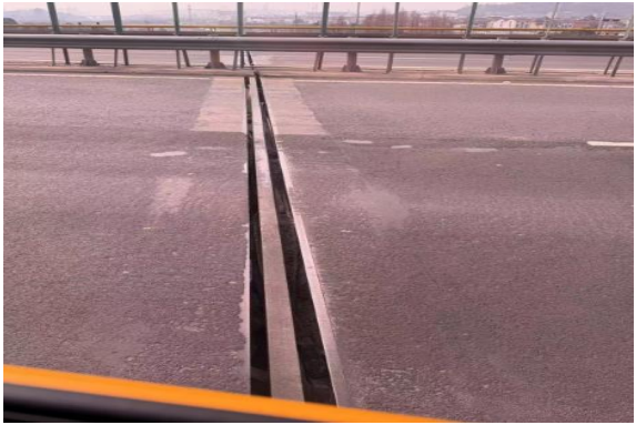
图 17 44#墩伸缩缝损坏
