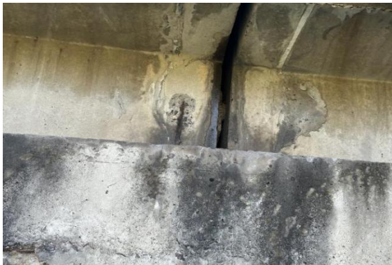
图 7-9-9#板梁, 左腹板, 1 处露筋
