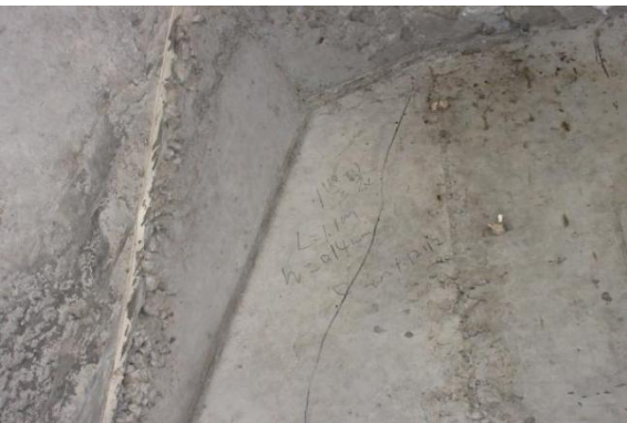
图 12-43-2#横隔板, 大桩号侧, 1 处竖向裂缝
