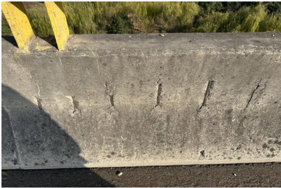
图 21 第 6 联护栏，左侧露筋锈蚀
