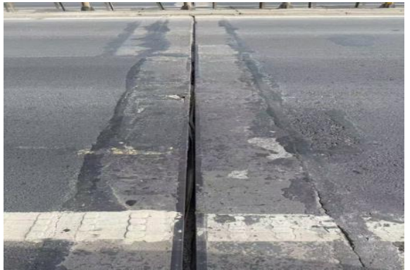
图 34 22#墩伸缩缝失效
