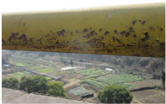
图 35 第 13 联钢扶手锈蚀涂层脱落
