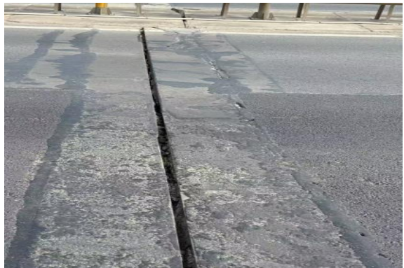
图 33 10#墩伸缩缝失效
