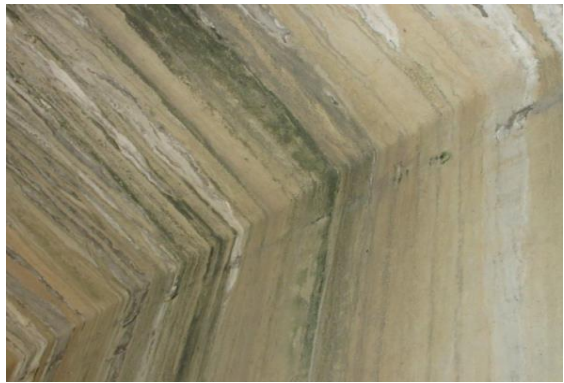
图 9-20-1#箱梁右腹板, 8 处露筋
