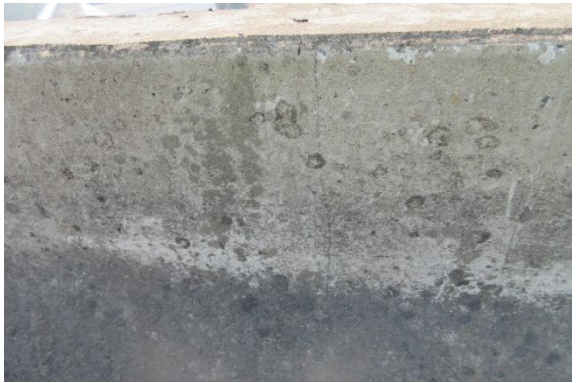
图 36 第 6 联砼护栏竖向裂缝
