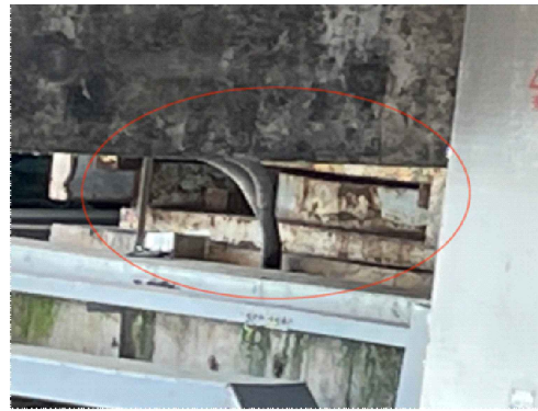
图 4-15 7#墩轻微水冲刷
