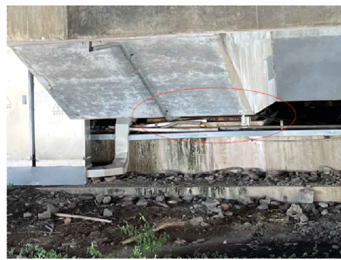
图 4-16 7#墩轻微水冲刷
